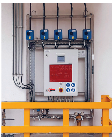
Bild 3: N 2 Ventilstation, Klärschlamm-silos
